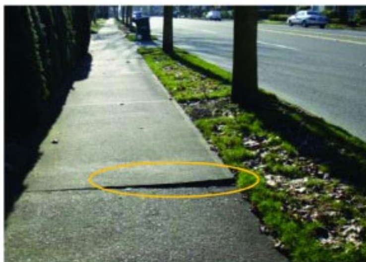
شکل (۵) ناپیوستگی عمودی در سطح پیاده رو یا پیاده راه
